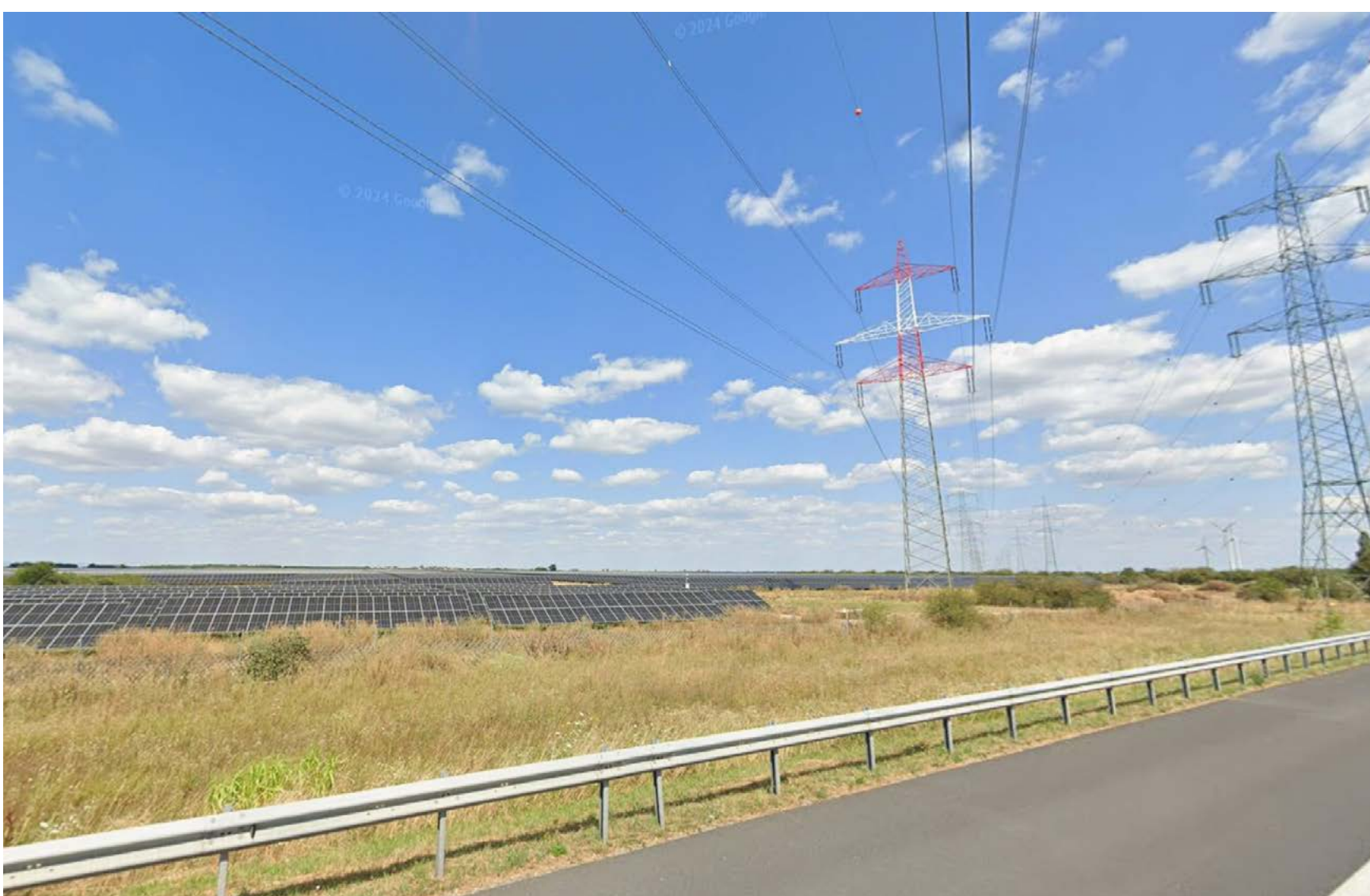
Bündelung von Energieinfrastruktur – Beispiel Photovoltaik
